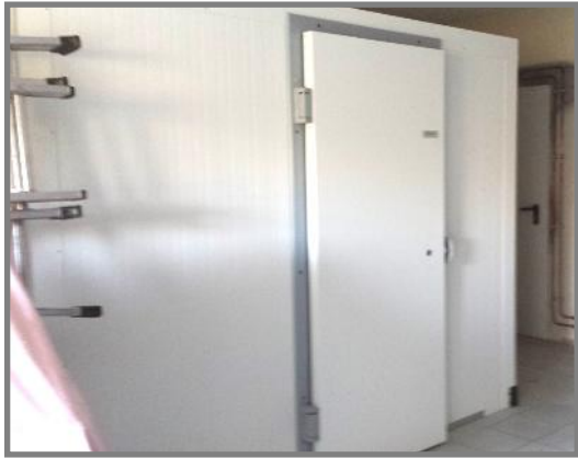
Nouvelle chambre froide
